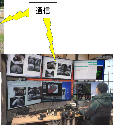
遠隔監視・操作室
